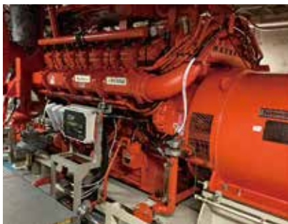
東日本旅客鉄道株式会社 仙台駅様 (900kW×2台) ▲
