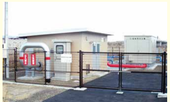
緊急時ガス受入設備(バックアップステーション)▲
