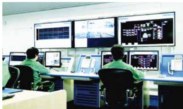
港工場コントロールセンター▲
