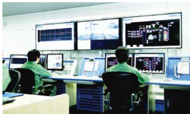
港工場コントロールセンター▲
