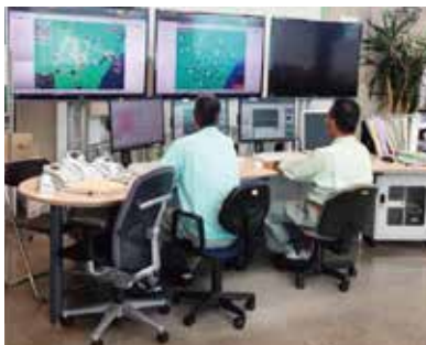
幸町コントロール室▲
