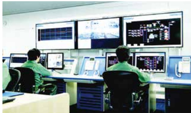
港工場コントロールセンター▲
