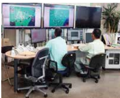
幸町コントロール室▲
